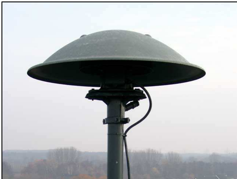
Bild: Sirene Typ E57 In allen Ortsteilen der Gemeinde Dornstadt installiert.
